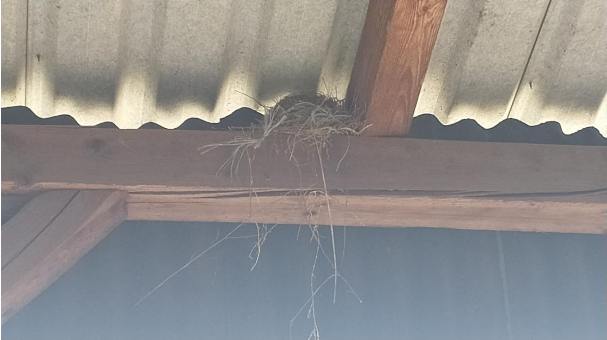
Abbildung 6: Altes Nest eines Nischenbrüters im Scheunenanbau.
